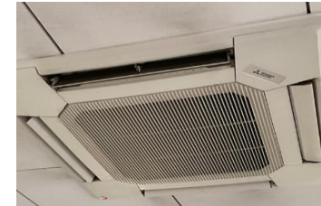
Fan coil unit
